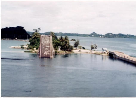
1996年9月崩壊したKB橋 右側は仮の浮き橋
